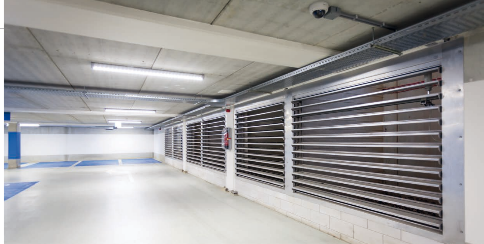
Colt mechanische ventilatie in parkeergarage
